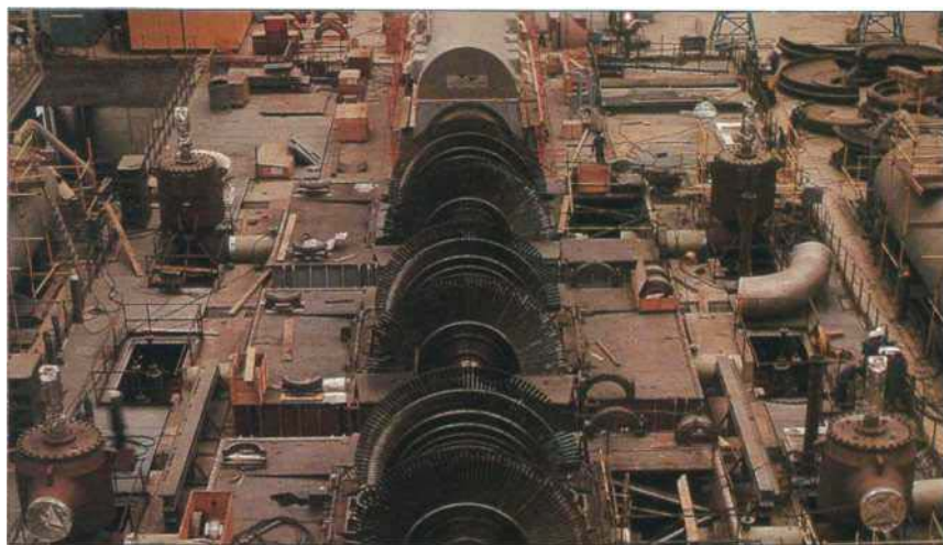
Groupe turbo-alternateur EDF du Blayais; les développements en cours conduiront à la surveillance et au diagnostic automatiques de ces ensembles industriels, grâce à des techniques de traitement du signal et d'intelligence artificielle. (ClichéG. Jaumotte.SODEL, photothèque EDF).
